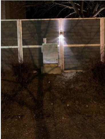
Figur 3. Mätstation vid kvarteret Ungern 5, foto Örnsköldsviks kommun.
